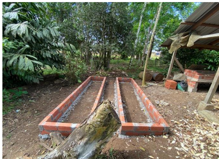
Imagen 24. Camas para elaboración de compost de residuos orgánicos en Wasakentsa. Fuente: La consultora
