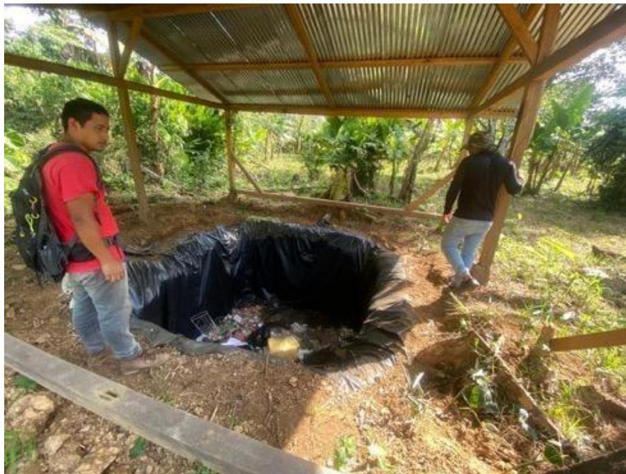
Imagen 22. Hoyo sanitario en Wasakentsa Fuente: La consultora
